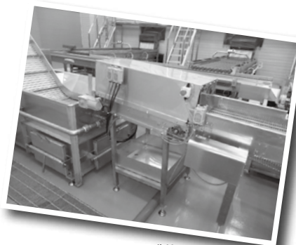
シャワーリング装置
